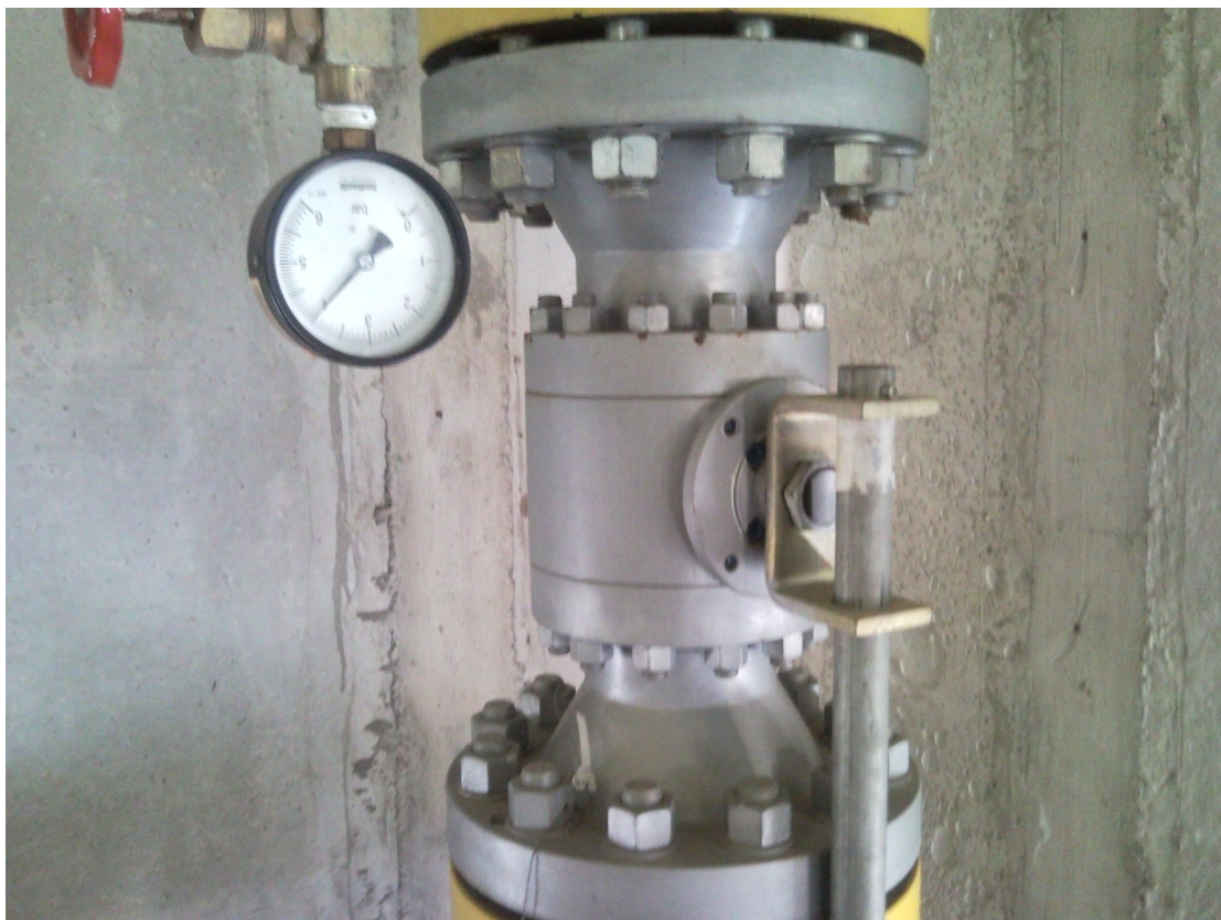
CABINA REMI FOTO N° 7
