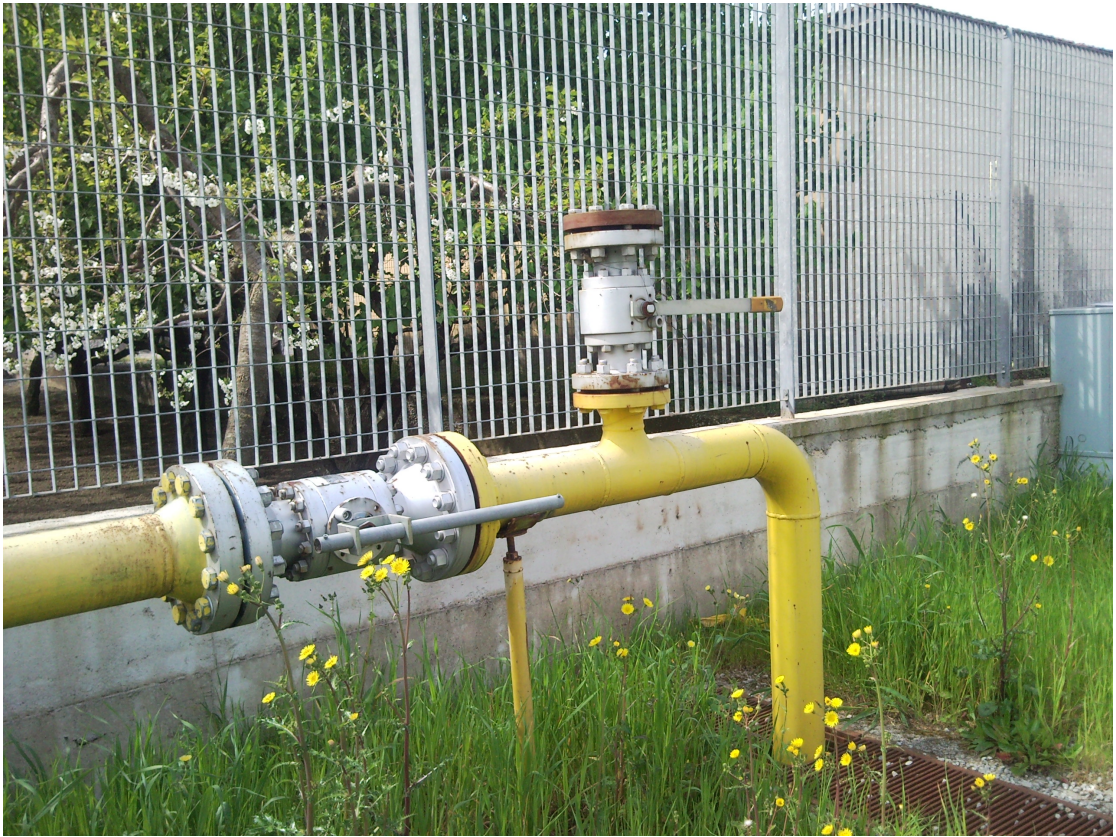
CABINA REMI FOTO N° 3
