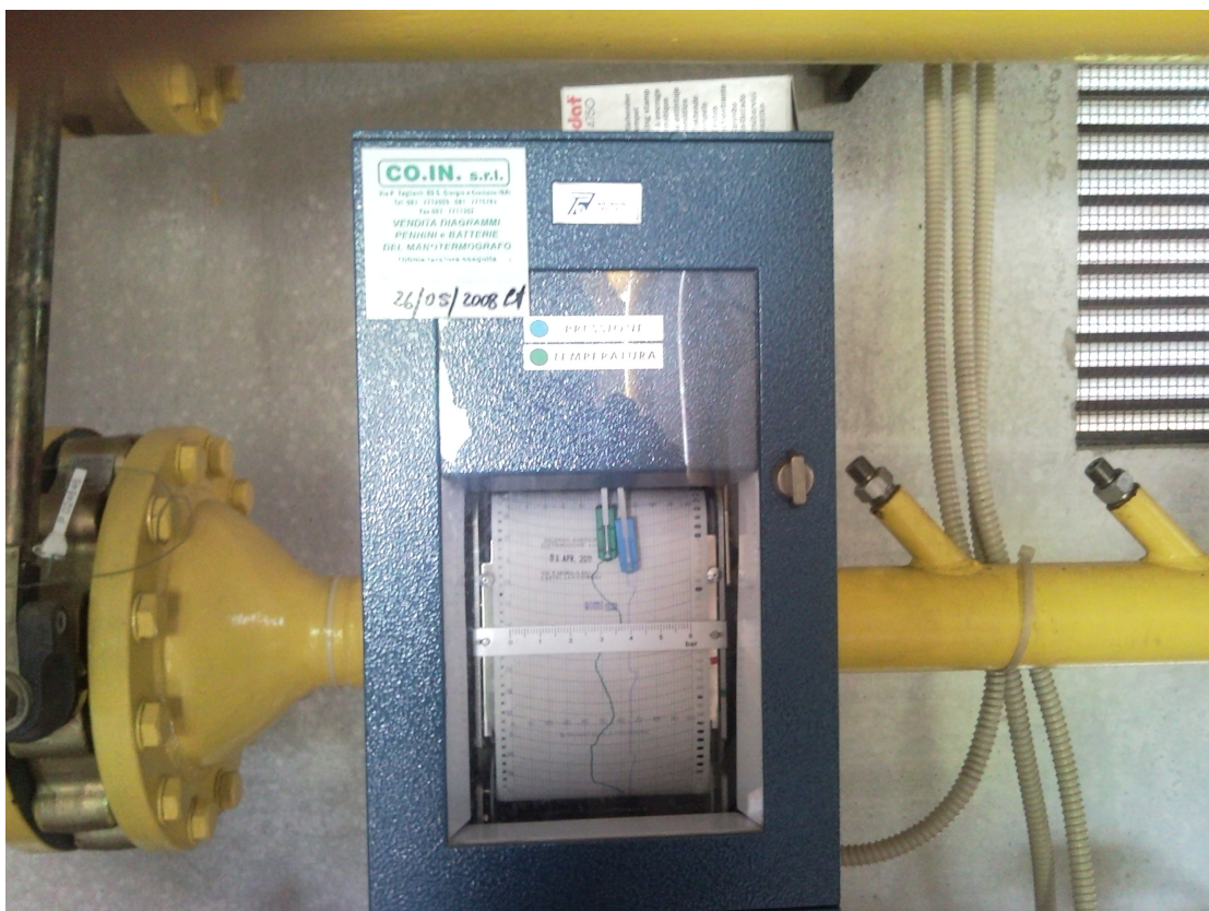
CABINA REMI FOTO N° 8
