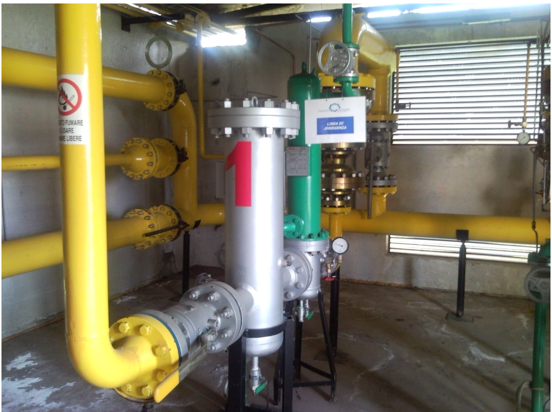
CABINA REMI FOTO N° 4
