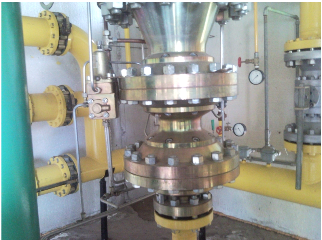
CABINA REMI FOTO N° 6
