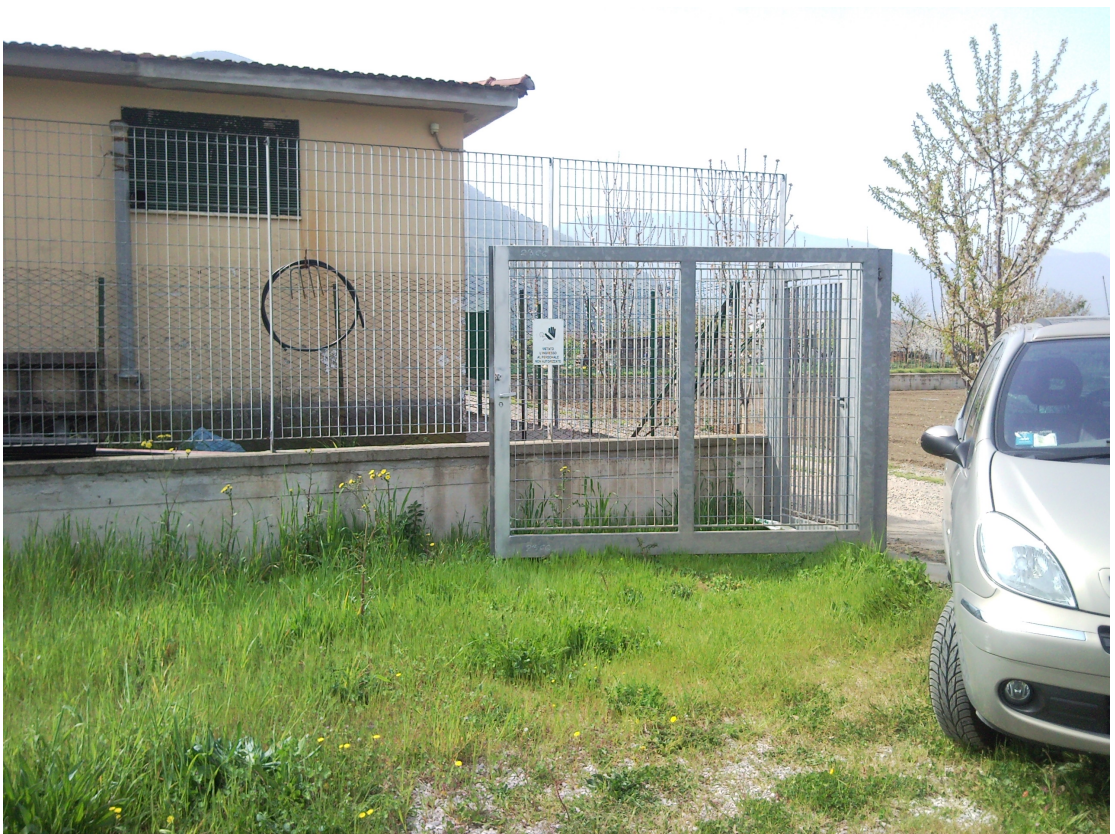
CABINA REMI FOTO N° 2
