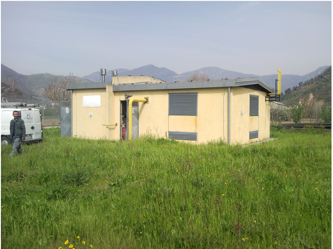
CABINA REMI FOTO N° 1
